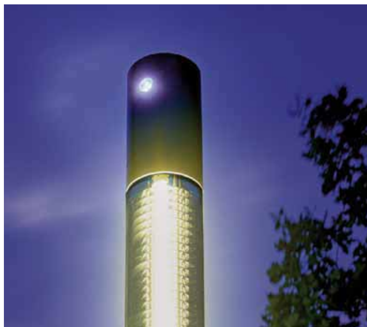
Poste de luz en el patio de acceso al estadio HSH Nordbank Arena, en Hamburgo. DRAGONpuck® se utiliza en la parte superior del poste para indicar el camino (fuente: SITECO).
